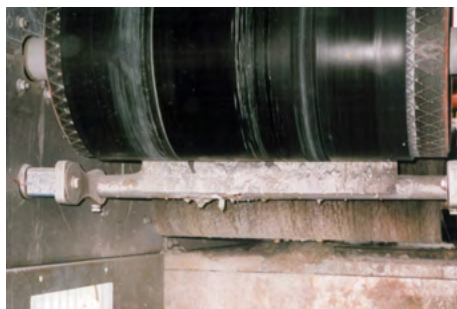
Gurtreinigung mit Hartmetallabstreifer Belt cleaning with carbide tipped belt scraper
