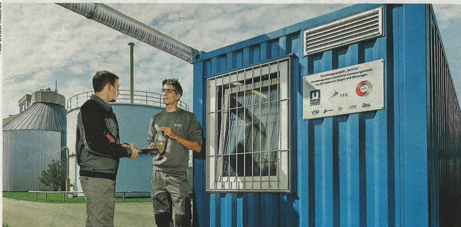
Pilotanlage für die Rückgewinnung von Stickstoff in kommunalen Kläranlagen – die Montanuni Leoben ist Vorreiterin
