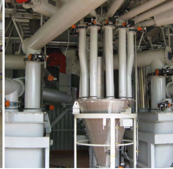
Beschickung einer Zementwaage mit Entstaubungsfilter Dosing into cement weighhopper with dedusting filter
